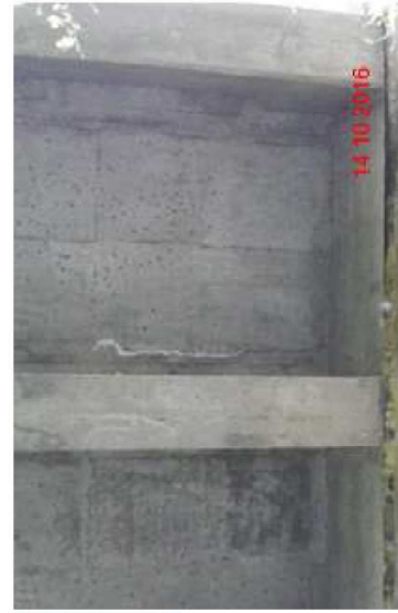
Foto 8. Fissura com eflorescência na laje - face inferior.
