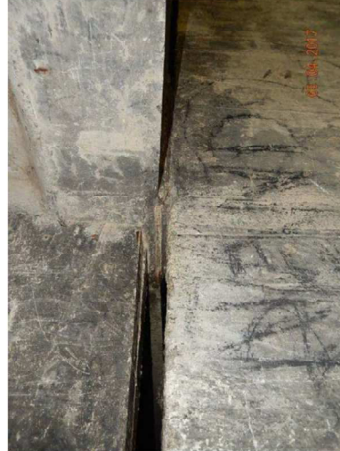
Foto 8. Aparelho de apoio em neoprene deteriorado.
