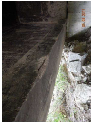
Foto 7. Concreto disgregado com armadura exposta e corroída na viga longitudinal.
