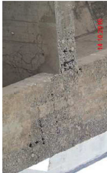
Foto 5. Concreto segregado com armadura exposta e corroída na viga longitudinal.
