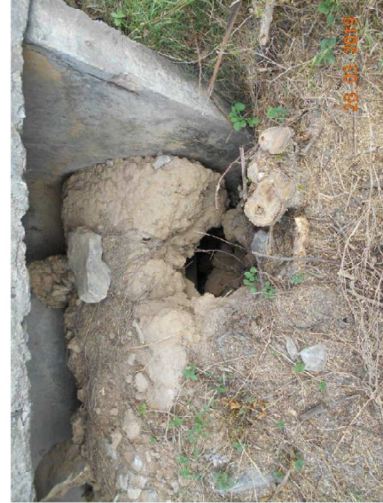
Foto 8. Erosão do talude junto a cortina.
