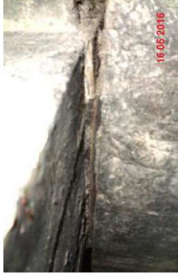
Foto 6. Aparelho de apoio em neoprene deteriorado.
