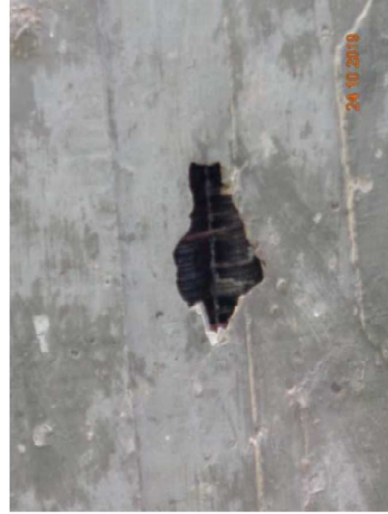
Foto 4. Concreto segregado com bainhas do cabo de protensão expostas.
