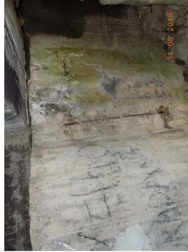
Foto 8. Concreto disgregado com armadura exposta e corroída na viga travessa.
