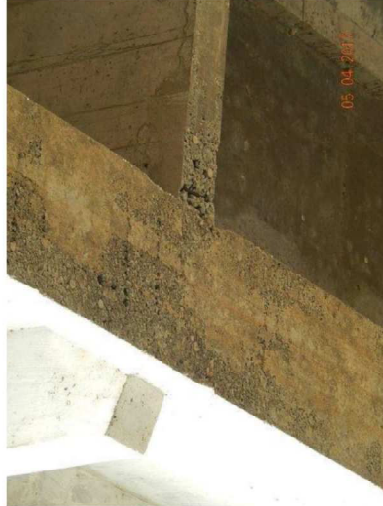
Foto 6. Concreto segregado com armadura exposta e corroída na viga longitudinal e transversina.
