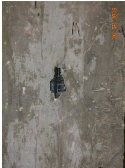
Foto 5. Concreto segregado com bainhas do cabo de protensão expostas.
