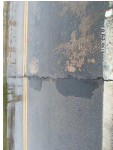
Foto 11. Junta de dilatação no encontro com degrau entre o tabuleiro e o terrapleno.
