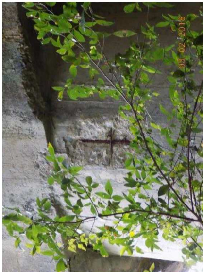
Foto 9. Concreto disgregado com armadura exposta e corroída no pilar.
