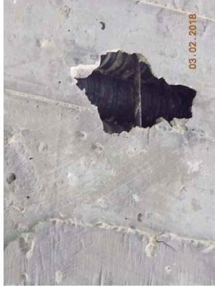
Foto 6. Viga longitudinal com bainhas do cabo de protensão expostas.
