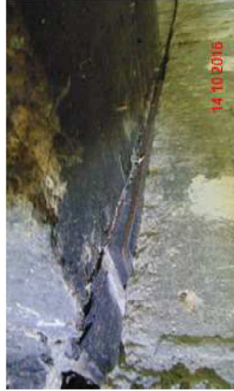
Foto 6. Aparelho de apoio em neoprene deteriorado.
