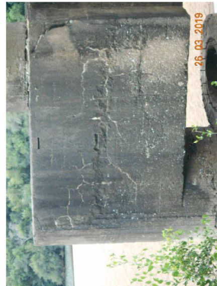
Foto 7. Fissuras aleatórias na viga de travamento inferior.
