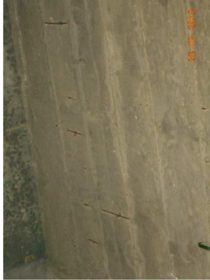
Foto 6. Concreto disgregado com armadura exposta e corroída na viga longitudinal.
