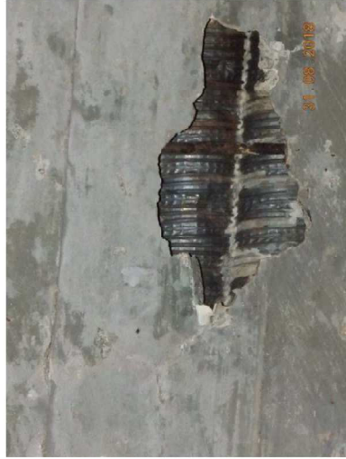
Foto 6. Viga longarina com bainhas do cabo de protensão expostas.
