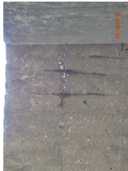
Foto 7. Concreto disgregado com armadura exposta e corroída na viga de travamento inferior.
