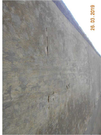
Foto 4. Concreto disgregado com armadura exposta e corroída na laje em balanço.
