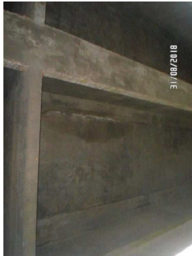
Foto 5. Fissura com efflorescência na face inferior da laje.
