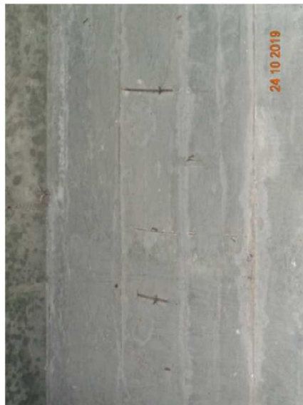
Foto 5. Concreto disgregado com armadura exposta e corroída na viga longitudinal.
