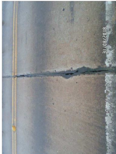
Foto 9. Junta de dilatação intermediária com deterioração do material de vedação.
